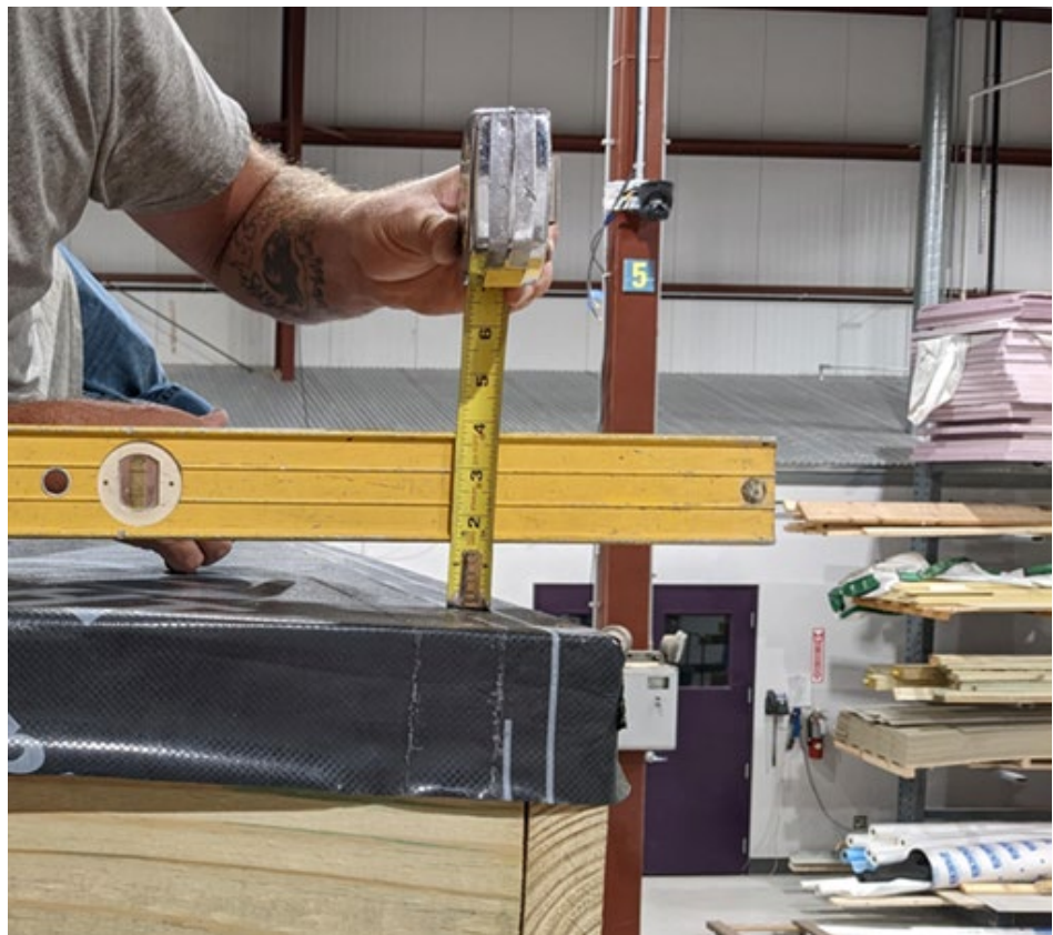
Figura 52. Pendiente de 2% (6,35 mm por 30,48 cm) Lejos al Muro
